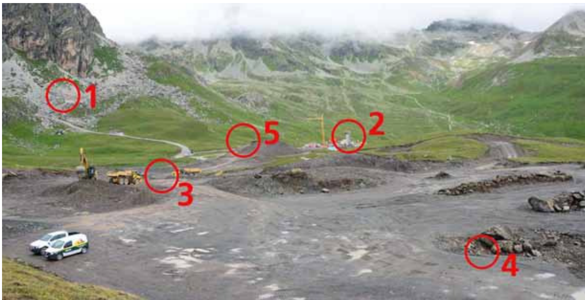
Die Grossbaustelle: Kiesentnahme und Verarbeitung vor Ort (1). Bau der Pumpstation des Naturspeichersees (2). Materialabtrag zur Dammschüttung (3). Zwischenlagerung von Steinen, die später wieder in den Damm eingebaut werden (4). Dammschüttung (5). Foto: Reto Stifel
