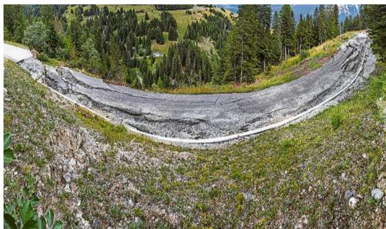
Zerklüftet und abgerutscht: So präsentiert sich die Kantonsstrasse zwischen Mathon und Wergenstein. (FOTO JANO FELICE PAJAROLA)
