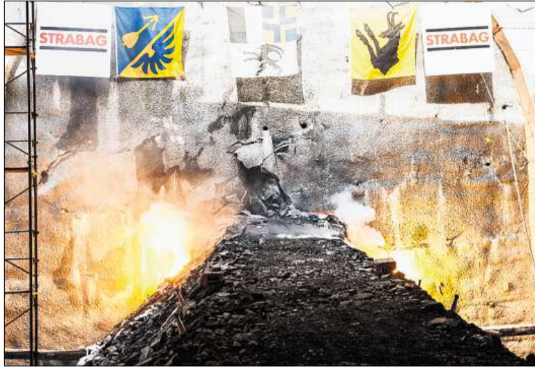
Ein Meilenstein ist erreicht: Begleitet von einem prächtigen Feuerwerk wird die Tunnelwand durchbrochen. (Fotos Marco Hartmann)
